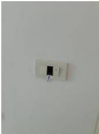
4. ติดตั้งอุปกรณ์สวิตช์ไฟไม่ครบ
