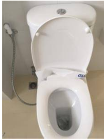
เช็คระบบชักโครก กดน้ำไม่ลง ถึง2ครั้ง
