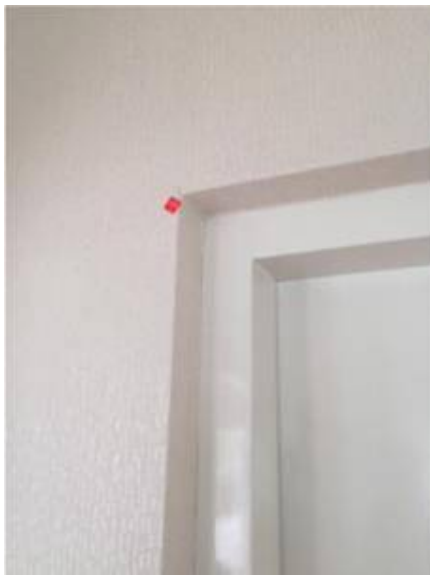
Wallpaper ขาดตรงมุม
