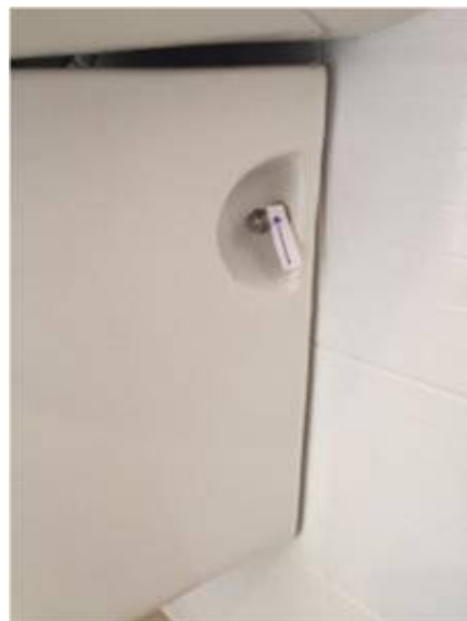
ฉีดอ่างล้างหน้าขึ้นสนิม เปลี่ยนใหม่
