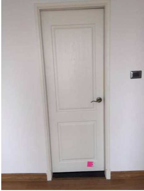
1. เก็บงานสีประตูใหม่ทั้งด้านนอกและด้านใน
