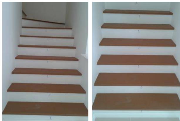
1.เก็บงานรอยแยกตรงบันไดทุกชั้น
