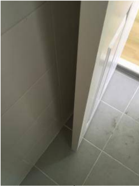
3. กันชนประตูไม่ได้ติดตั้ง
