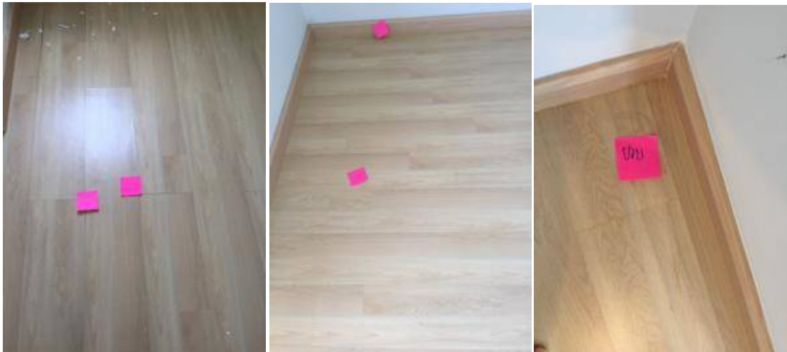
1. พื้นบวมหรือทำใหม่บริเวณหน้าห้องน้ำ+ พื้นยวบมูมห้อง
