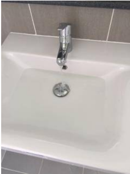
6. ก๊อกน้ำไหลไม่แรง เช็คอุปกรณ์เช็คระบบท่อ+กระเบื้องได้อ่างแตก เปลี่ยนใหม่
