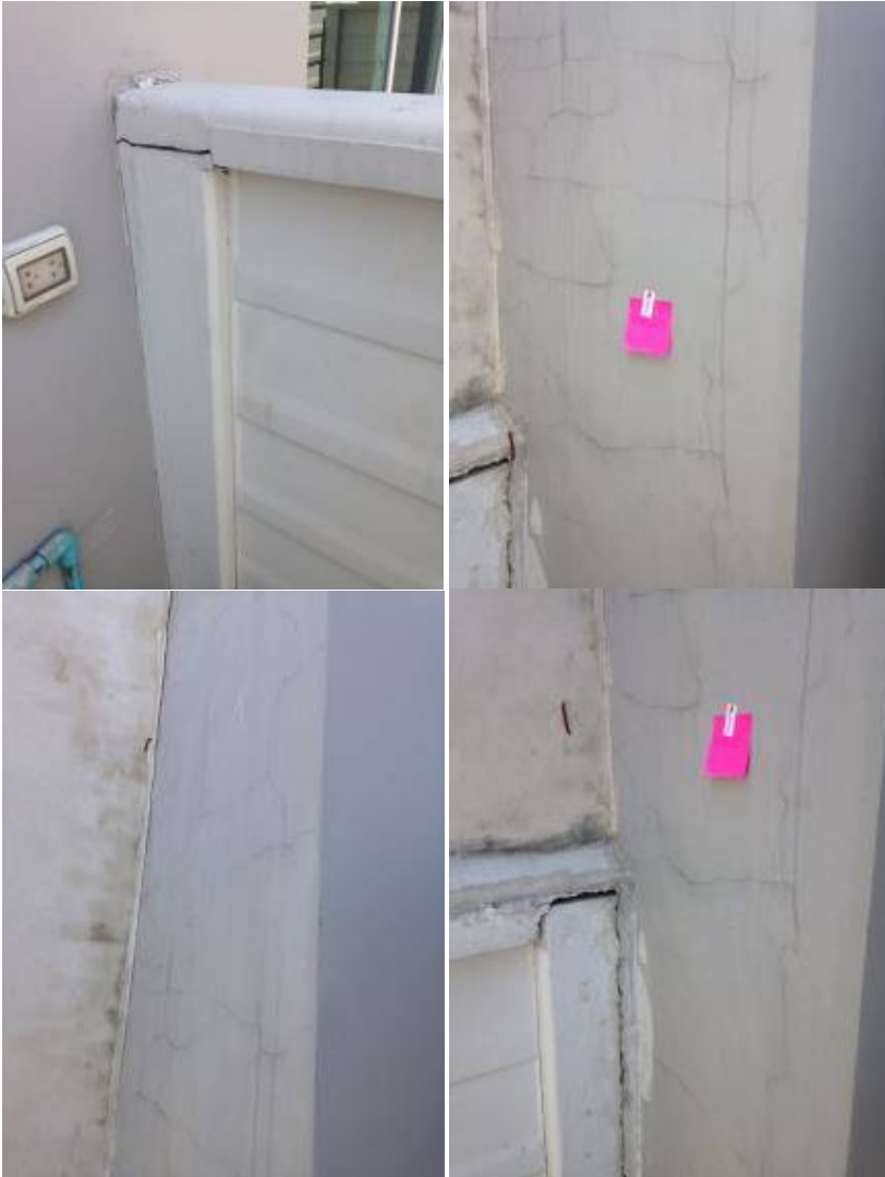
5.ผนังและกำแพงมีรอยแตกร้าว. เก็บสิ่งงานผนังใหม่.
