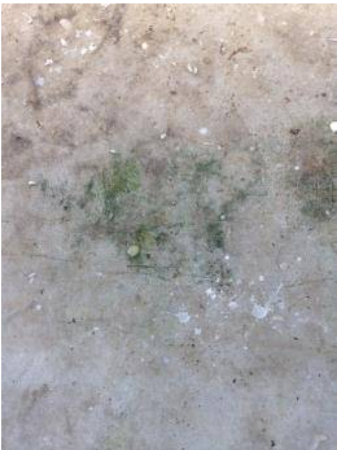
3. หลังบ้านยังไม่ได้ลงเข็ม+ขัดพื้นแตกผิวปูนใหม่
