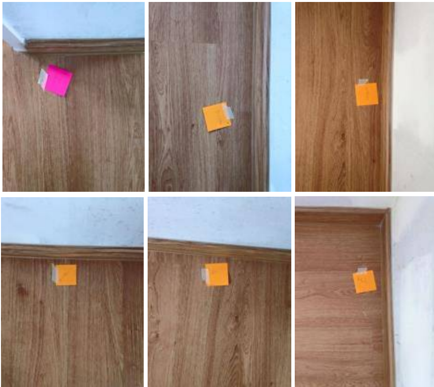
พื้นยวบ+พื้นมีเสียงดัง+เก็บงานซิติโคนบัวโดยรอบทั้งหมด
