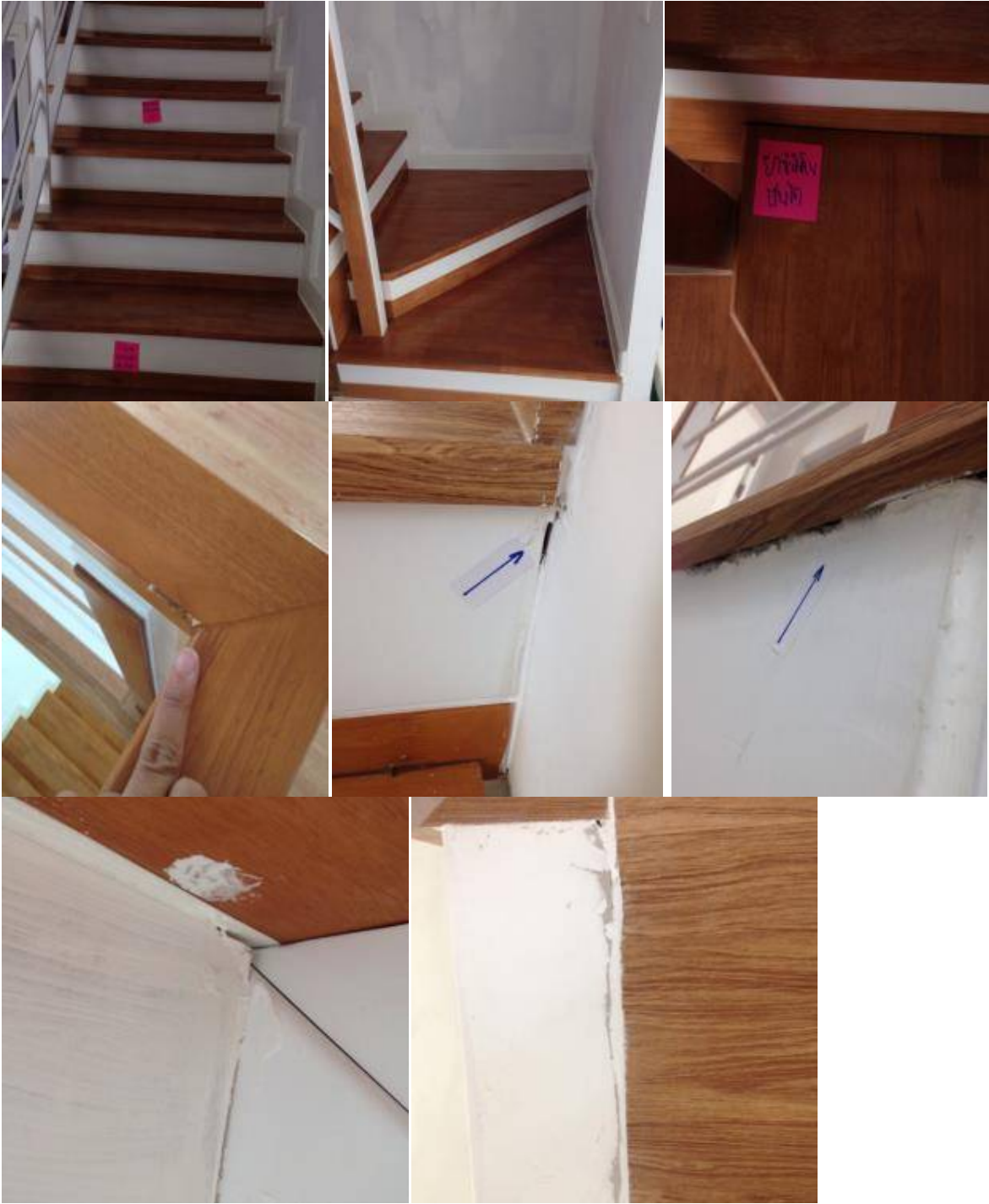
1.ทำความสะอาดลูกตั้งลูกนอนบันได+ยาซิลิโคนขอบบันได+เก็บงานสีบันได รวบรวมกันตก
