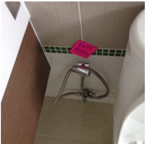
2. สายชำระชั้นสนิม+มีน้ำรั่วซึม เปลี่ยนใหม่
