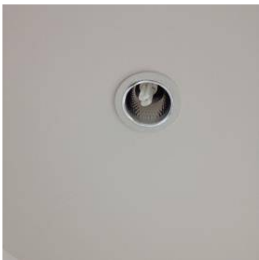
4. ขอบอะลูมิเนียมดาวไลท์บุบ เปลี่ยนใหม่
