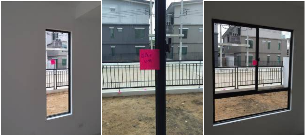
4.เปลี่ยนกระจกหน้าต่าง1บาน+ทำความสะอาดหน้าต่างประตูกระจกทั้งหมด+ตามเฟรมหน้าต่าง.
