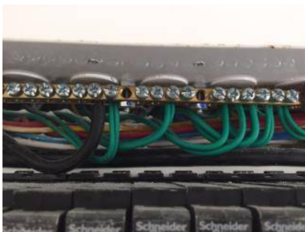
แยกสายดินออกจากกันไม่ได้ รวมกัน สายหนึ่งเส้น น๊อตหนึ่งตัว
