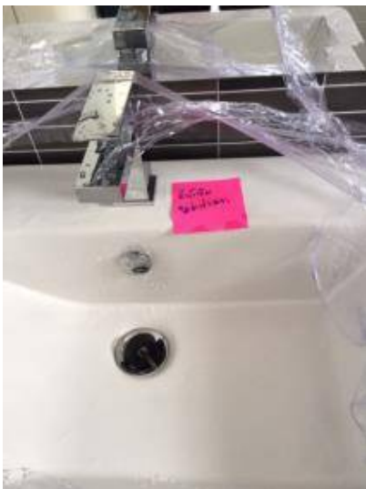
2.มีน้ำรั่วซึมอ่างล้างหน้า
