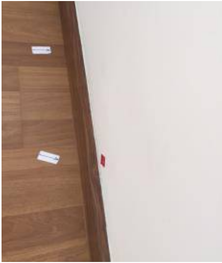
3. ซิลิโคนบัวที่ไม่เต็มเซ็คโดยรอบห้องทั้งหมด
