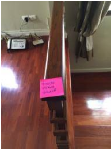
2. ซ่อมแซมราวกันตกเพราะโยก
