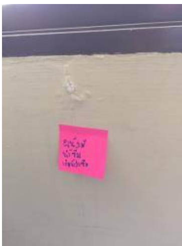
4. ตรงหน้างานพักผนังน้ำรั่วซึม
