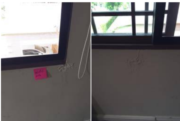
3. ผนังมีน้ำรั่วซึมบริเวณหน้าต่าง
