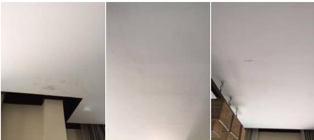
5. ฝ้า เซ็คน้ำรั่วซึม+ฝ้าเพดานเป็นคลื่นเก็บสีฝ้าใหม่
