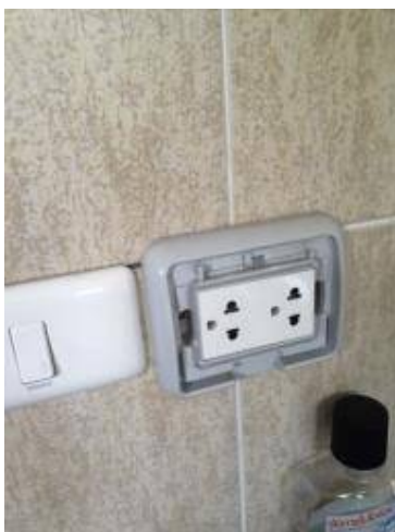
7. ปลั๊กไฟไม่มีที่ปิดกั้นน้ำ
