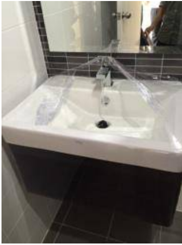
3. ก๊อกน้ำไหลไม่แรง เช็คอุปกรณ์ *หมายเหตุไม่มีปั้มน้ำ
