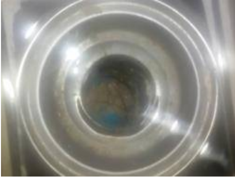
3. มีเศษปูนในท่อระบายน้ำชั้นล่าง
