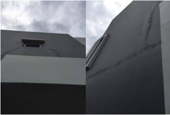
3. เช็ดผนังมีน้ำรั่วซึมทาสีภายนอก
