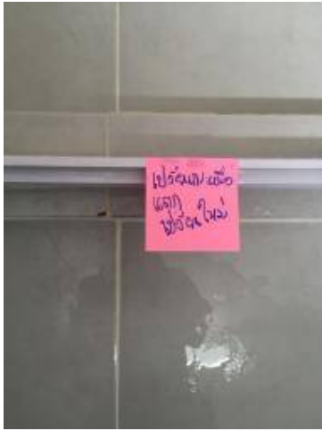
7.กระเบื้องห้องอาบน้ำแตกเปลี่ยนใหม่
