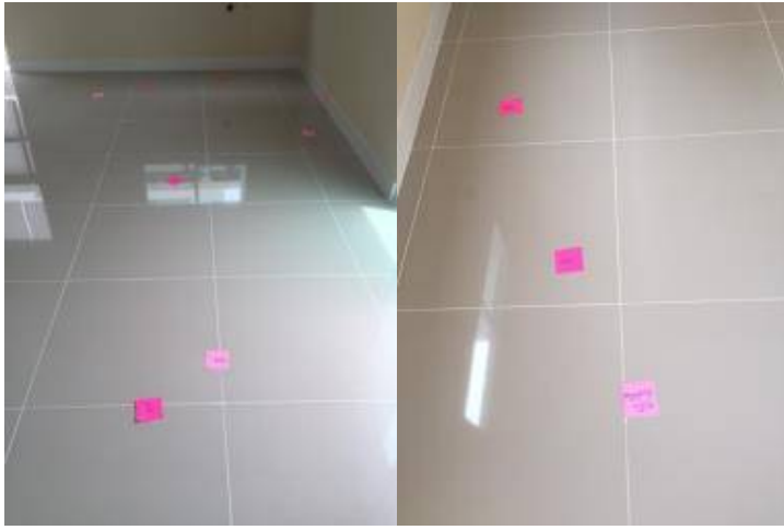
4. กระจกเป็นรอยขีดทุกแผ่น+กระจกโพรงเปลี่ยนกระจกใหม่
