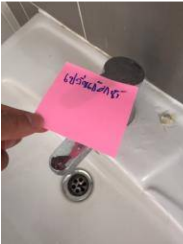
2. ก๊อกน้ำเป็นคราบ เปลี่ยนก๊อกน้ำ
