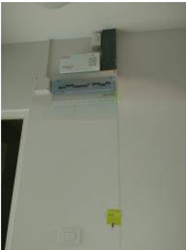
3. กล่องไฟชั้น2โดนน้ำ เปลี่ยนใหม่
