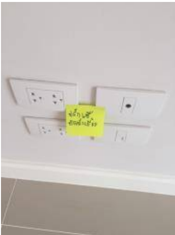
12. ปลั๊กติดตั้งเบี่ยง ไม่สวยงาม
