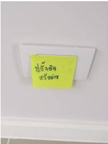
9.ปลั๊กติดสลับด้าน
